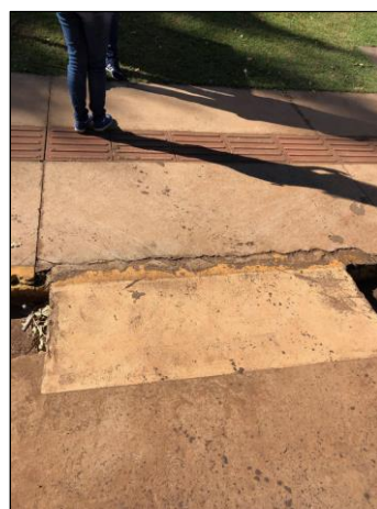
Figura. 9. Intersecção da calçada com a rua sem a devida marcação de piso tátil, 2019.
